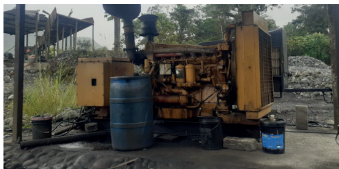
Planta eléctrica minería ilegal río jatunyaku inspección 2023
